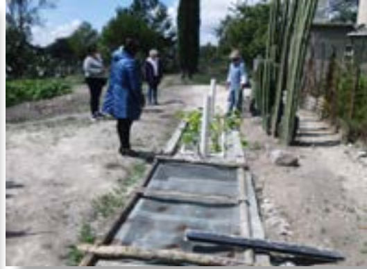
Humedal para filtración de aguas grises en San Miguel Tlazintla, Cardonal, Hgo. Fotografía: Magueyal, AC.
