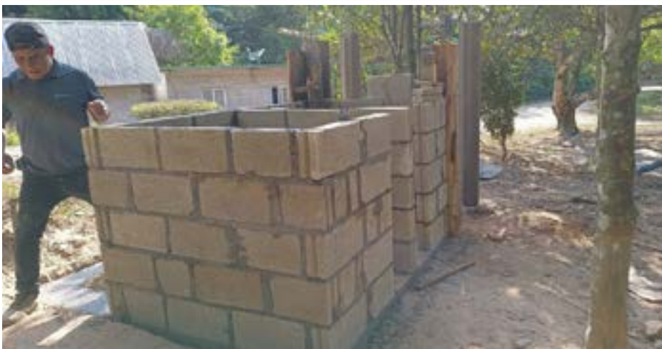
Autoconstrucción de los baños secos, San Juan Lalana, Oax. Fotografía: Paciano Reynaldo Bautista Velasco.
